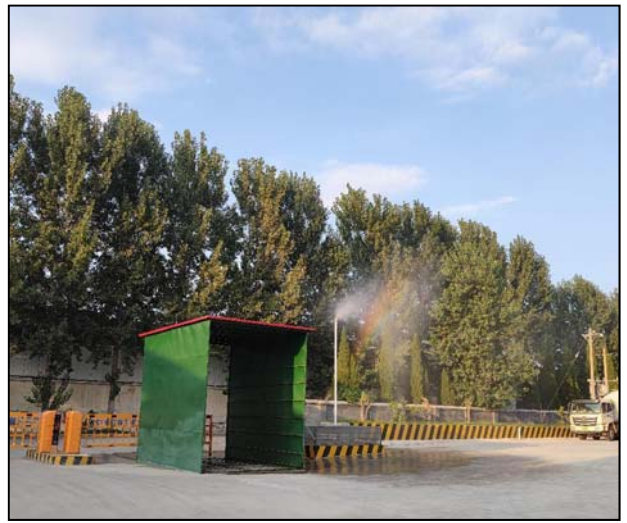
项目共用车辆冲洗装置
